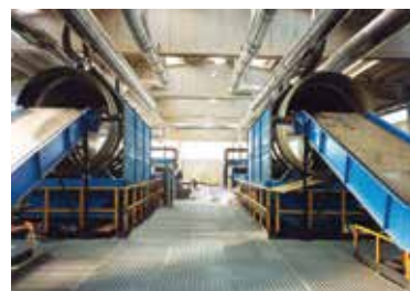
Installations complètes intérieures
